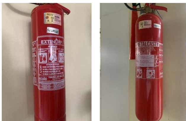
Extintores localizados no prédio da Biblioteca Central com datas de validade vencidas.
