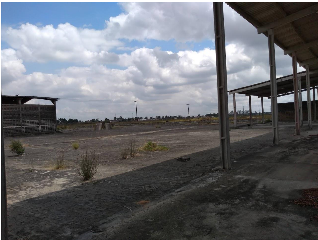
Foto 3: A garagem permanece sem utilização, aguardando a finalização de ajustes.
