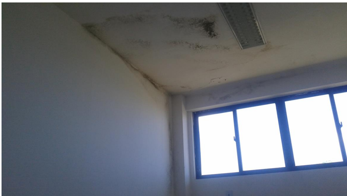
Foto 8: Prédio do 3º centro de saúde/FAMED: sinais de infiltração no teto superior e mofo nas paredes
