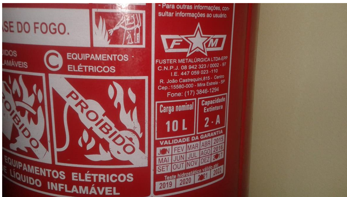
Foto 1: Prédio do Lema/CTEC: Extintor com validade de garantia vencido desde janeiro de 2017.
