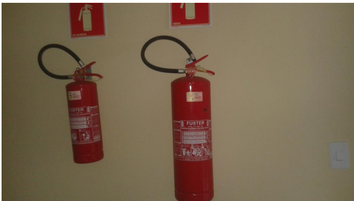
Foto 2: Prédio do Lema/CTEC: Extintores dispostos no prédio
