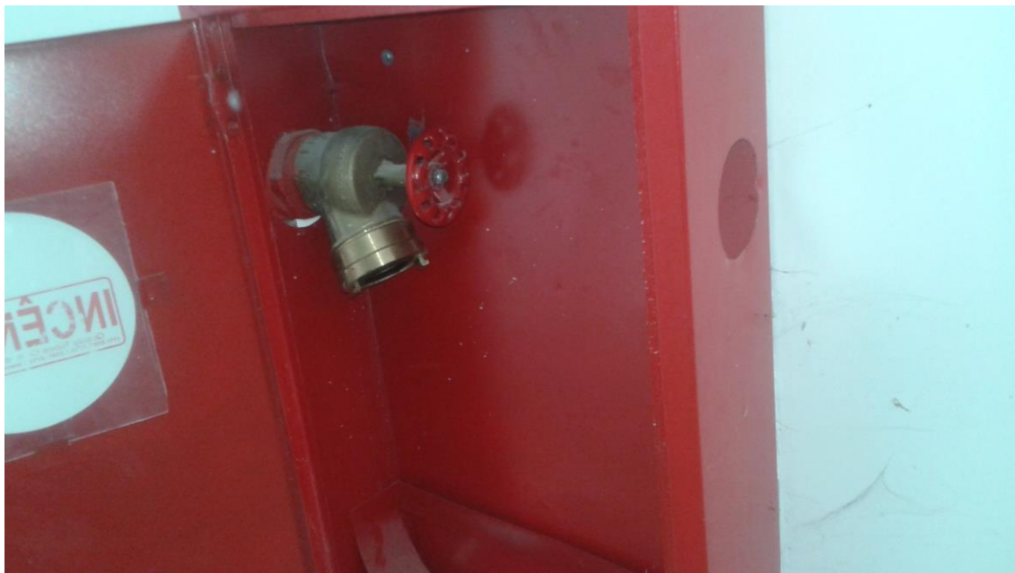
Foto 9: Prédio do 3º centro de saúde/FAMED: Estrutura de incêndio entregue sem a mangueira da água.
