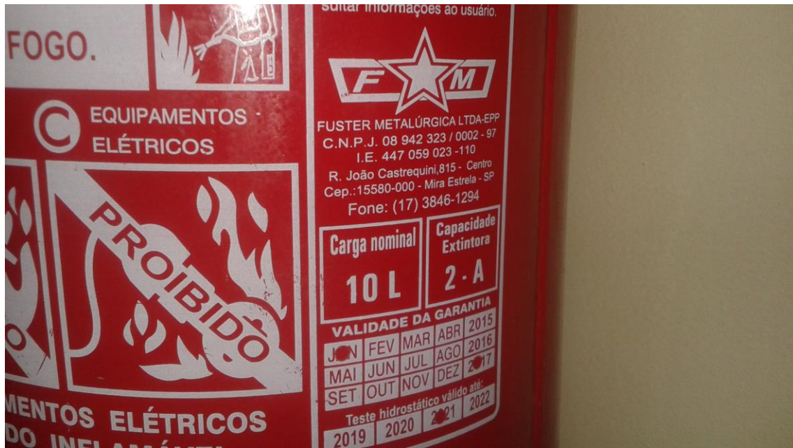
Foto 3: Prédio do Lema/CTEC: Extintor também apresenta validade de garantia vencido desde janeiro de 2017.
