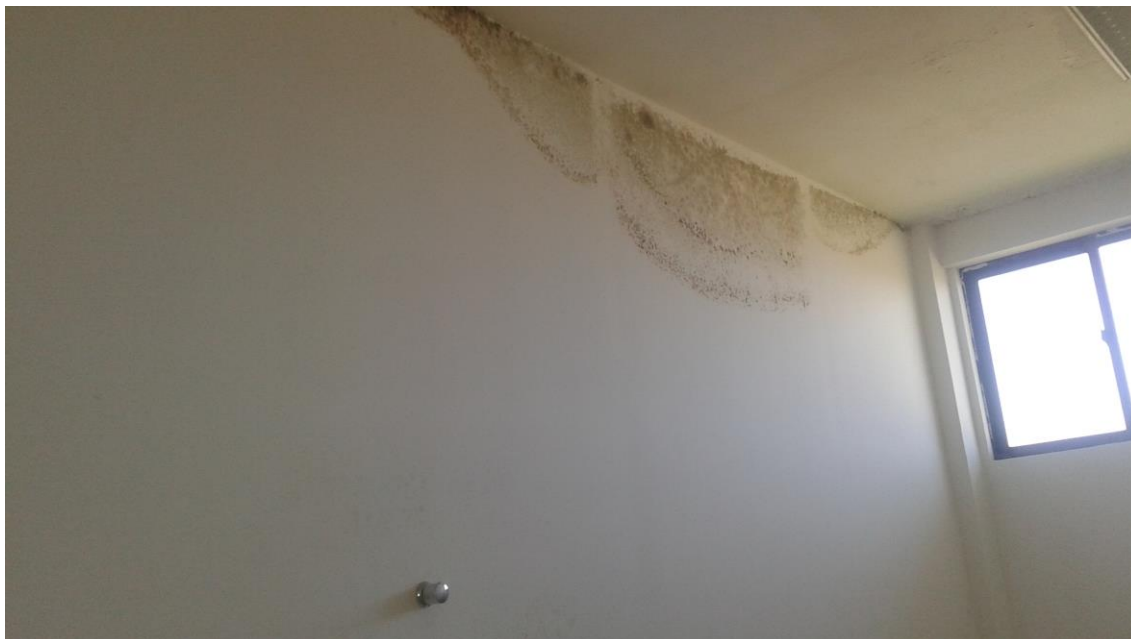
Foto 7: Prédio do 3º centro de saúde/FAMED: Prédio ainda não inaugurado, mas apresenta sinais de infiltração e mofo nas estruturas físicas.
