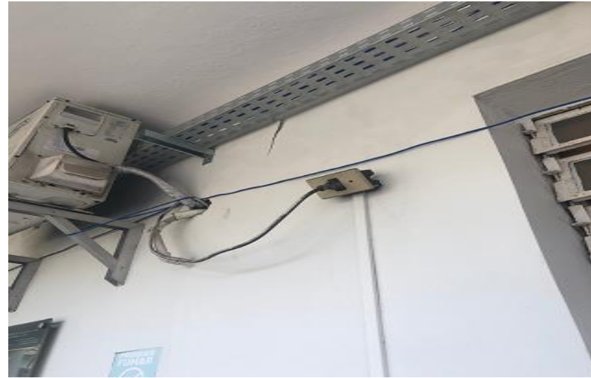
Foto 02: Fiação da rede elétrica substituída e caixa da tomada exposta.
