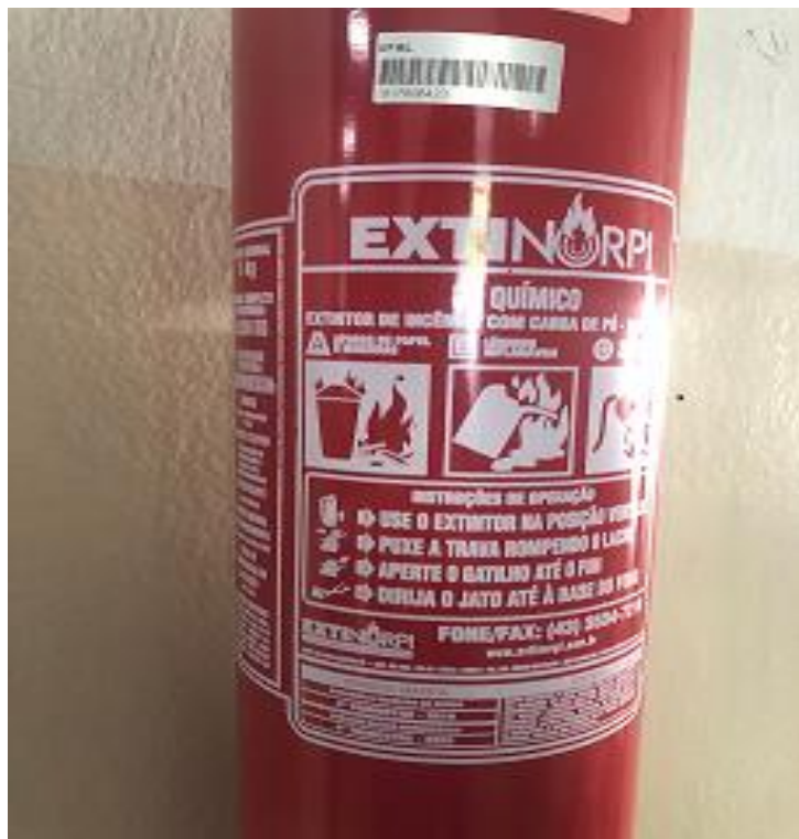
Foto 05: Novos extintores de incêndio.
