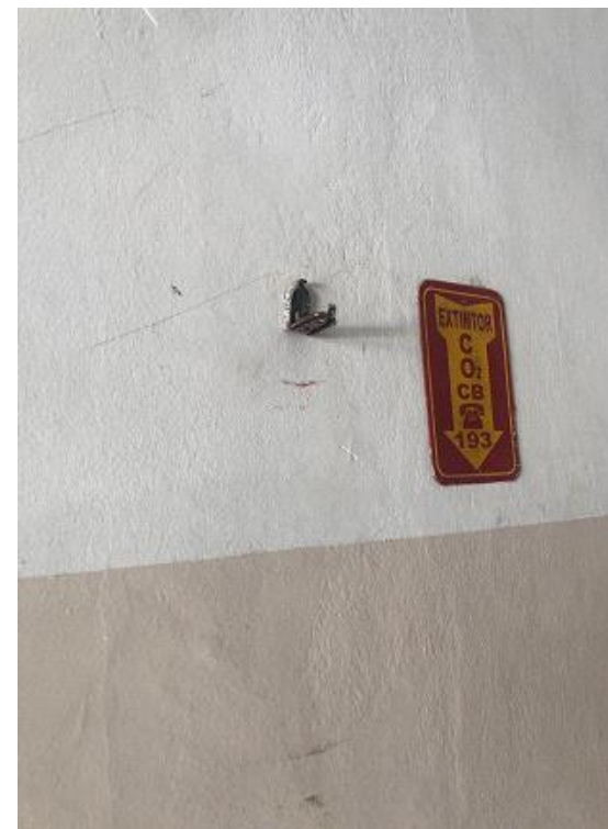
Foto 06: Suporte sem extintor de incêndio.
