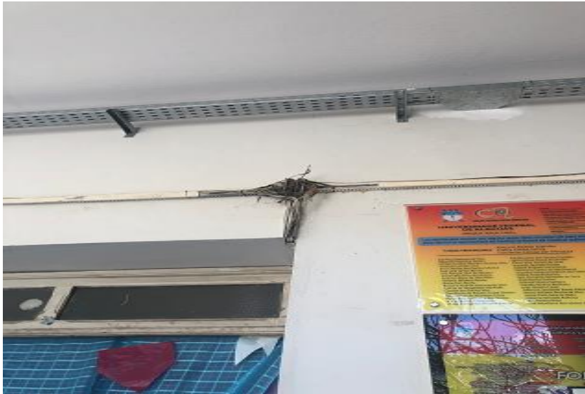
Foto 01: Fiação da rede elétrica antiga exposta.
