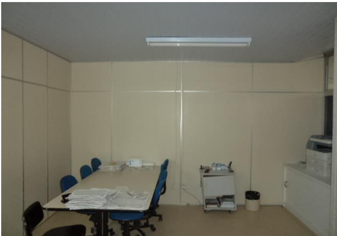
Foto 02 – Sala Auditoria Geral com lâmpada queimada
