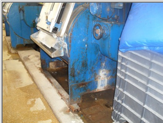
Maquina de lavar com pontos de ferrugem
