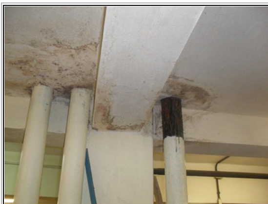
Infiltrações no teto
