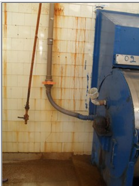
Cano de entrada de água com vazamento, piso molhado e desgastado e azulejos com ferrugem, com higiene prejudicada
