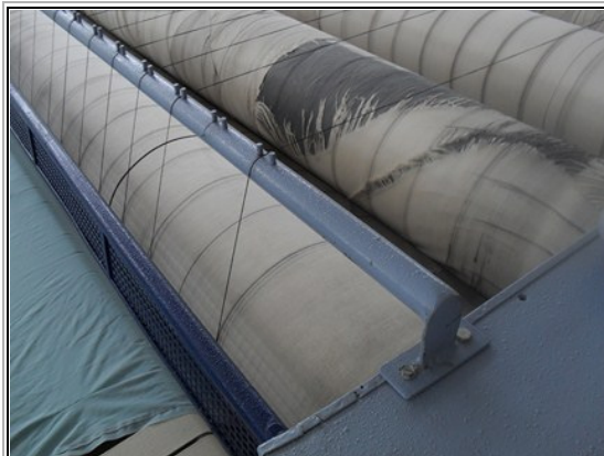
Material que recobre a calandra rasgado
