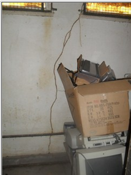
Presença de cupins nas paredes
